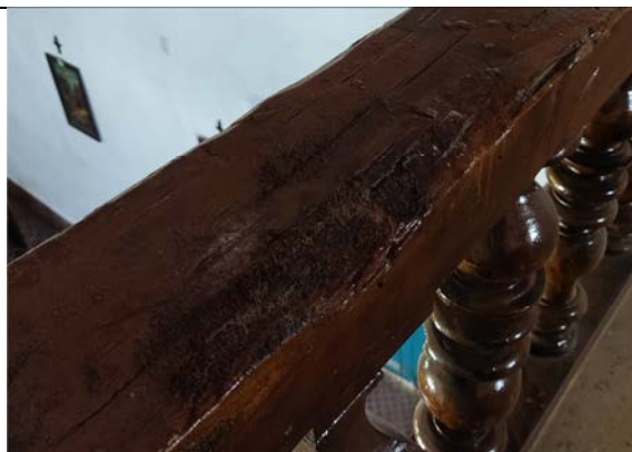
Foto 14: Trecho do parapeito da balastrada com indícios de recomposição, aparentemente com uso de pó de serra para reparo. Fonte: Alex Alves, 26 de setembro de 2024.
