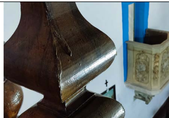
Foto 9: Acúmulo de produto, possivelmente verniz, sobre a superfície da balastrada, indicando tratamento para preservação. Fonte: Alex Alves, 26 de setembro de 2024.
