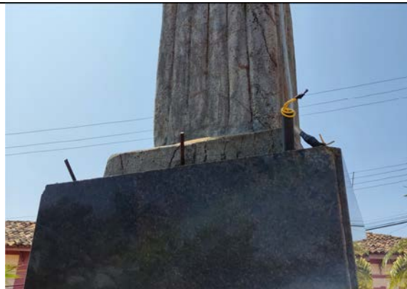
Foto 7: Instalações de dutos para passagem de energia localizadas no embasamento do Cristo, essenciais para o funcionamento das iluminações. Fonte: Alex Alves, 26 de setembro de 2024.
