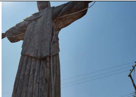
Foto 8: Perfurações visíveis na base do Cristo, realizadas para fixação das fitas de LED, evidenciando as adaptações necessárias para a iluminação. Fonte: Alex Alves, 26 de setembro de 2024.
