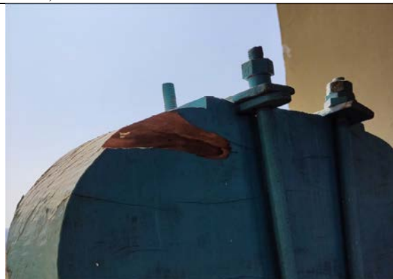
Foto 8: Vista do suporte do sino, mostrando a fixação da estrutura, que requer avaliação quanto à resistência e à necessidade de reparos ou substituições. Fonte: Alex Alves, 26 de setembro de 2024.
