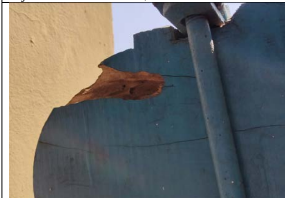
Foto 7: Perda de parte da madeira do suporte do sino, indicando a ocorrência de ataque de xilófagos, o que pode comprometer a segurança e a funcionalidade do sino. Fonte: Alex Alves, 26 de setembro de 2024.
