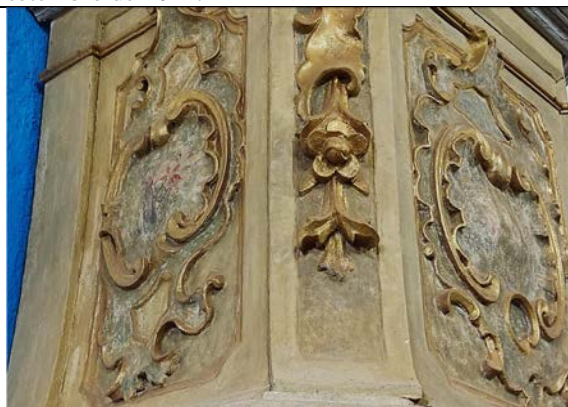
Foto 8: Detalhes do guarda-corpo do púlpito, mostrando a pintura artística que quase não é perceptível devido ao desgaste. Fonte: Alex Alves, 26 de setembro de 2024.
