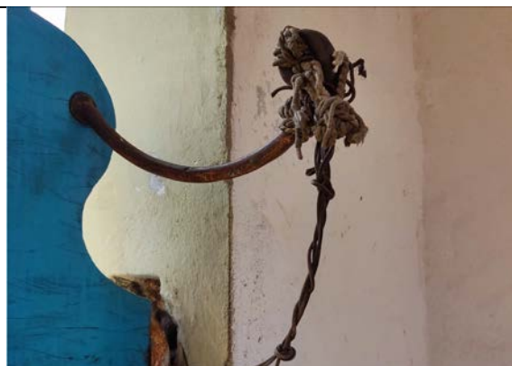
Foto 6: Mecanismo de acionamento do sino, com diversos nós e restos de corda, demonstrando as adaptações feitas ao longo do tempo para manter seu funcionamento. Fonte: Alex Alves, 26 de setembro de 2024.
