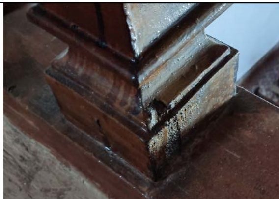
Foto 10: Parte desgastada da balastrada que aparenta ter sido reformada com material de aglomerado de pó de serra. Fonte: Alex Alves, 26 de setembro de 2024.
