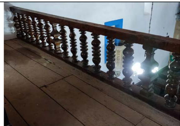
Foto 11: Visão geral da balastrada, com destaque para o piso do coro, onde observa-se o madeiramento exposto e ressecado, sem tratamento aparente. Fonte: Alex Alves, 26 de setembro de 2024.
