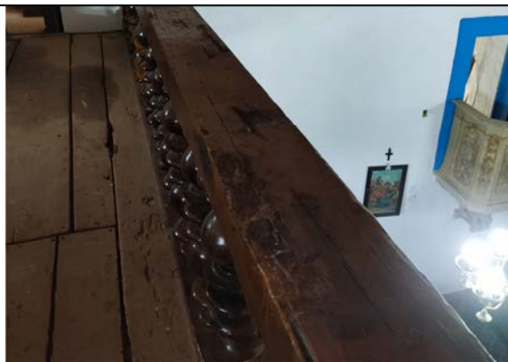
Foto 12: Parapeito da balastrada com manchas visíveis, sugerindo desgaste e a necessidade de restauração. Fonte: Alex Alves, 26 de setembro de 2024.
