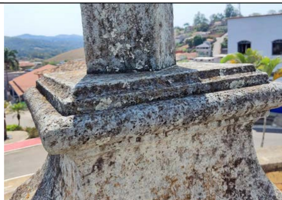
Foto 5: No embasamento do cruzeiro, observa-se sujeira acumulada, líquens e desgastes superficiais, evidenciando a degradação do material. Fonte: Alex Alves, 26 de setembro de 2024.
