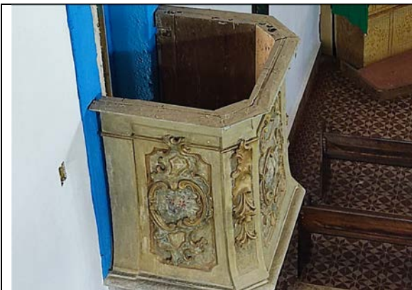
Foto 3: Vista superior do púlpito, onde é possível observar que sua aderência à parede não está muito segura, e o parapeito apresenta madeira desgastada. Fonte: Alex Alves, 26 de setembro de 2024
